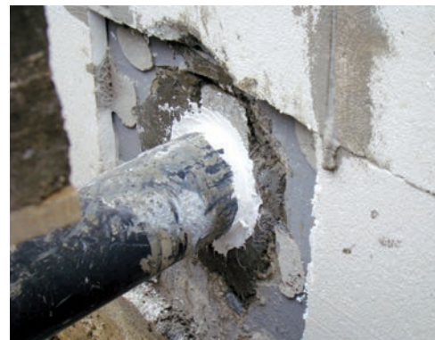
Depërtim të gypit përmes murrit nëntokësor
