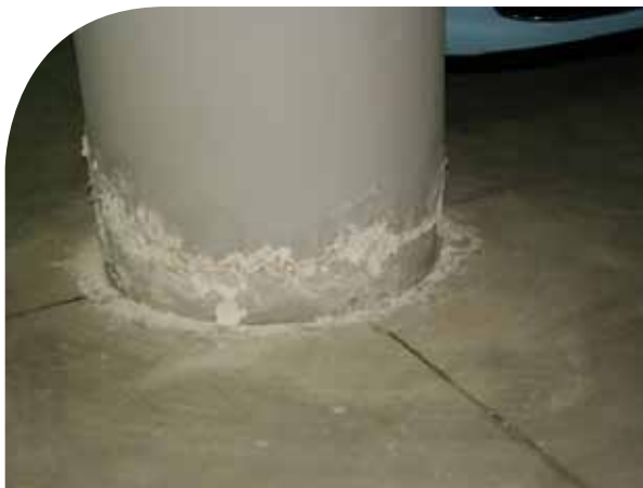
Efekat kapilarne apsorpcije vode u betonu
