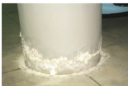
Efekt kapilane apsorpcije vode u betonu
