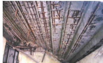
Degradacija betona izloženog na karbonizaciju
